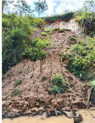
Fotografía 5.1 Deslizamiento activo en la vereda El Iris
