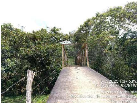
Pontón en vía interna, vereda Guacas Abajo
