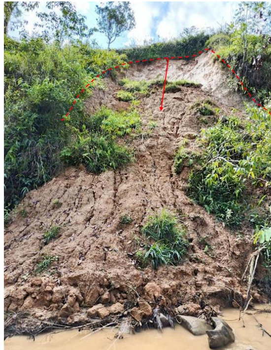
Fotografía 5.1.2.8 Deslizamiento activo en la vereda El Iris
